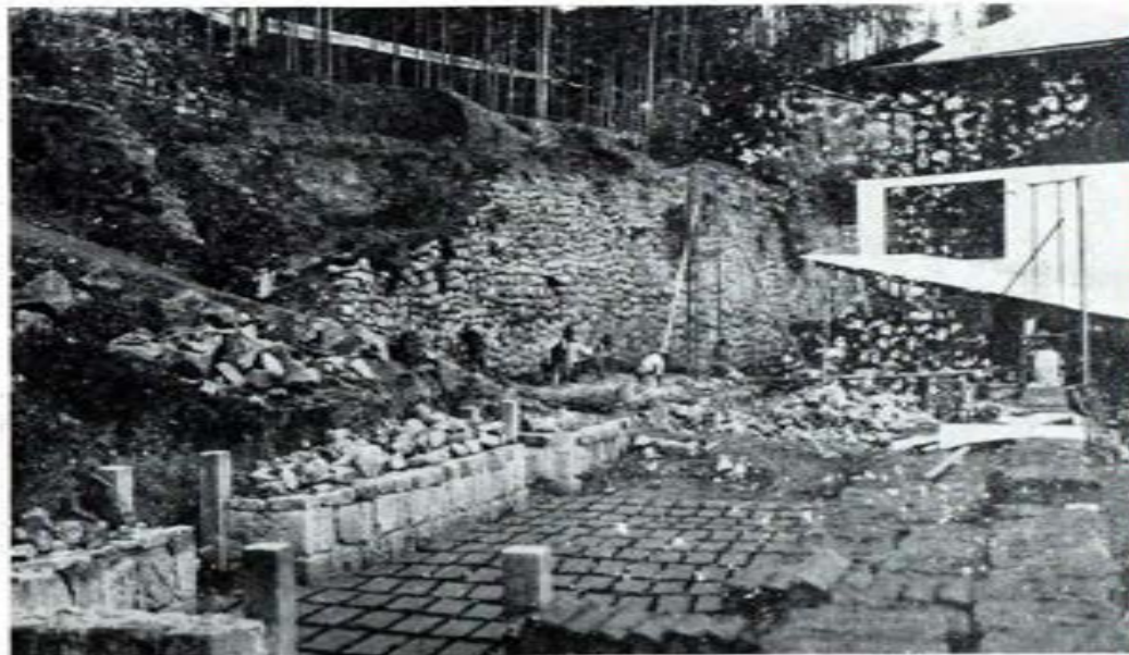
Escuela Vocacional del Cuzco. Construcción de los nuevos locales, que se espera terminar mediante el apoyo del gobierno y de la caridad de los buenos
